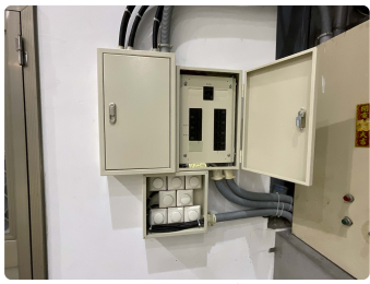
調光器及配電盤
